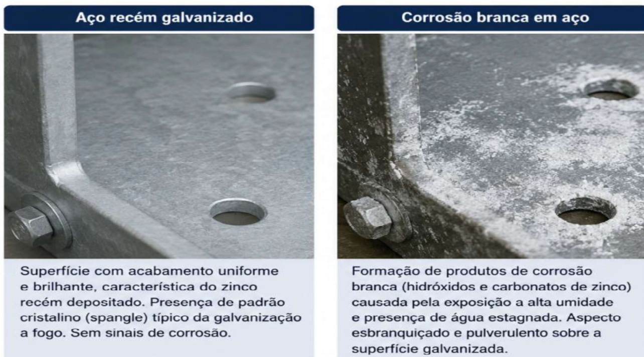
Figura 18: Exemplo ilustrativo de corrosão branca em peça galvanizada exposta a alta umidade - Aço recém galvanizado e Corrosão branca em aço
